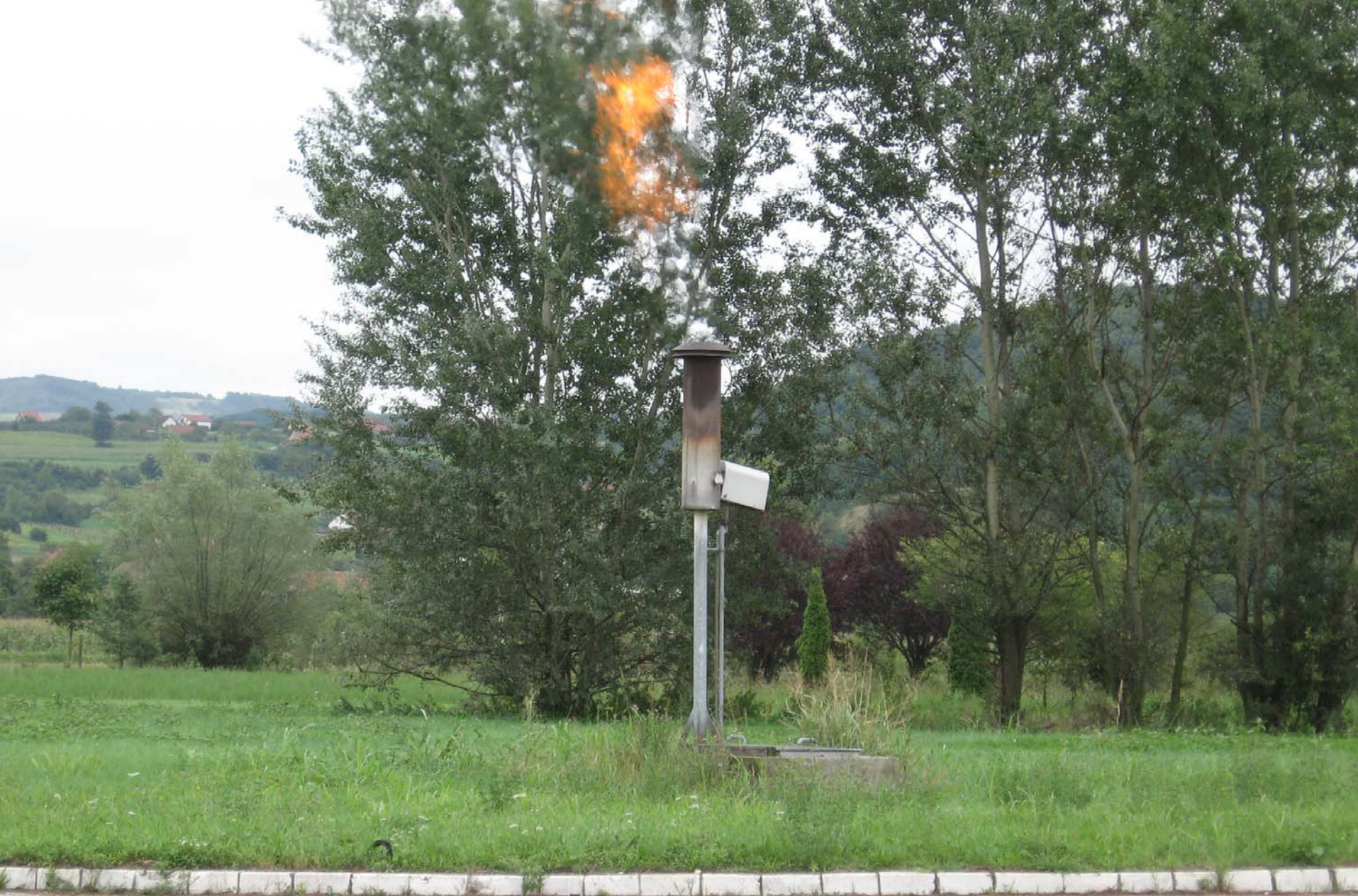
Baklja za spaljivanje viška bio gasa
